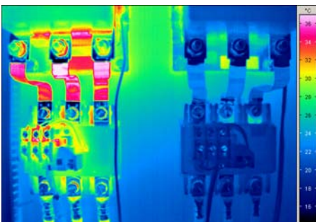
Img. 3 n.n. Switchboard
